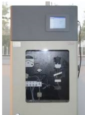
Thiết bị kiểm soát nước thải trực tuyến
